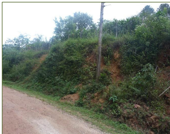
Local de ocorrência de Latossolos Vermelho-Amarelo cambissólico pouco profundo, desenvolvidos sobre substrato de mica xisto no entorno da área do Floreal Park. Notar escorregamento no talude.
